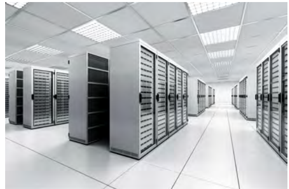
Fig. 4.4 : A data center
