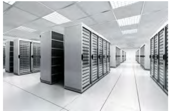
Fig. 4.4 : A data center
